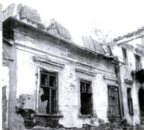
Dach dworu zawałił się do środka budynku
